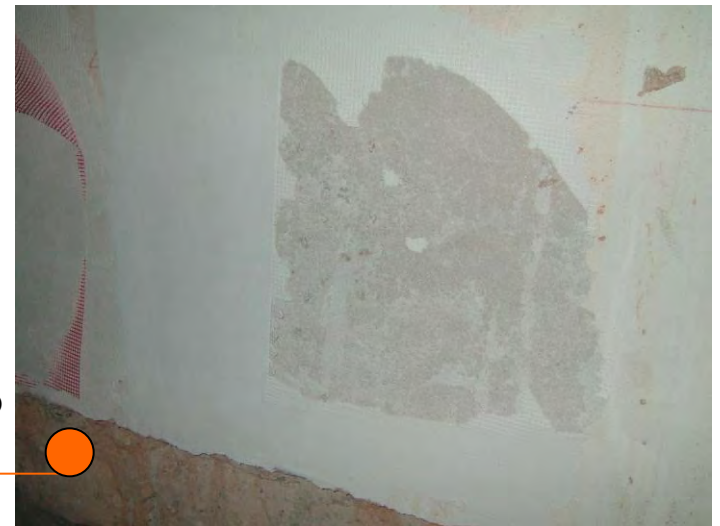
Rasante inadeguato o supporto troppo debole.
