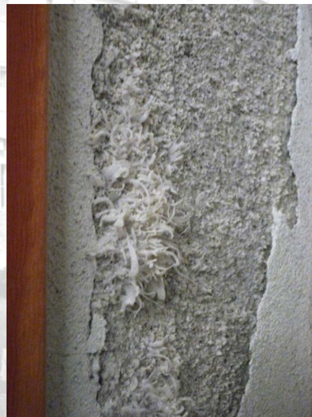
Intonaco su muratura interna di una civile abitazione in Chioggia, centro storico.
