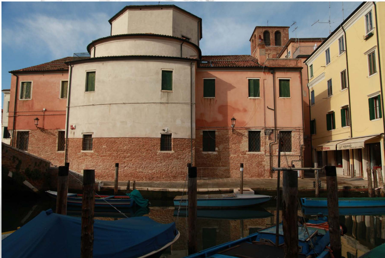
Prospetto est Chiesa di Sant' Andrea, Chioggia, con rimozione dell'intonaco nella parte basamentale.
